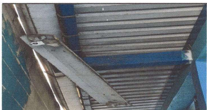
Foto 5: Sistema eléctrico: No hay iluminación.
